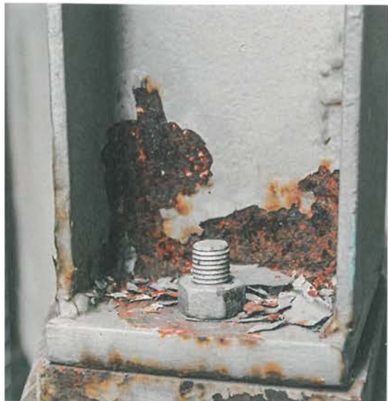
Sanierungsbedürftiger Stahlträger (oben) und Stelle, an der eine harte Sanierung nötig ist. (Bilder: Teko Oberflächentechnik AG und Raphael Briner)
