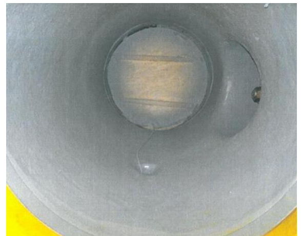
Zulaufleitung Bereich Druckregler
